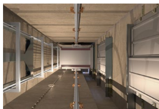
Binari per ascensori
