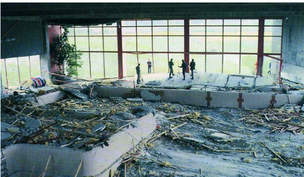
Nel 1985 a Uster (Svizzera), il controsoffitto sospeso in calcestruzzo di una piscina coperta è crollato. Gli elementi di sospensione del controsoffitto, in acciaio inossidabile, non mostravano alcun difetto esterno, ma in alcuni casi internamente erano completamente distrutti dalla corrosione sotto tensione.
