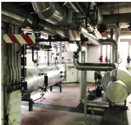
Il danneggiamento dei macchinari dopo il sisma può compromettere l'utilizzo dell'intera struttura.
