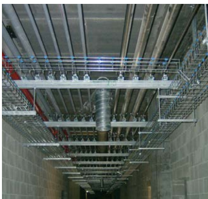
Impianto complesso in struttura strategica. La scelta dello staffaggio antisismico deve considerare le esigenze della normale funzionalità dell'impianto, come ad esempio consentire la dilatazione dei tubi.
